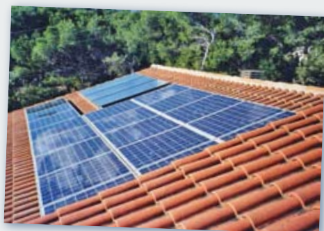
Panneaux solaires photovoltaïques
