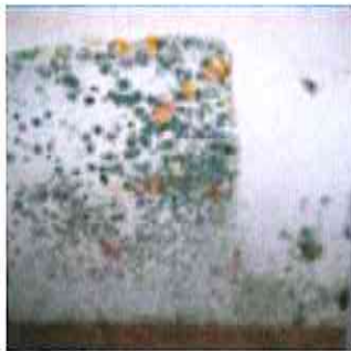
Contaminations fongiques sur un mur
