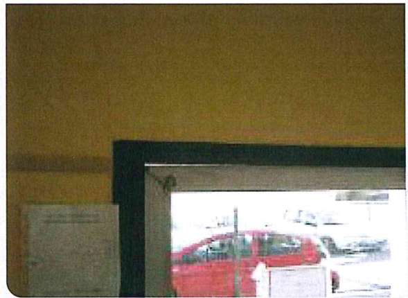
Photo 14 : Porte-fenêtre non étanche à l'air (jour visible)
