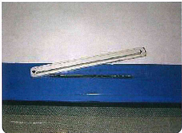
Photo 7 : Entrée d'air avec réservation trop étroite
