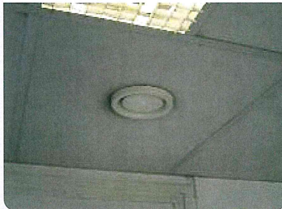
Photo 10 : Bouche de soufflage d'air dans une cantine
