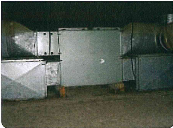
Photo 1 : Centrale double flux dans des combles
