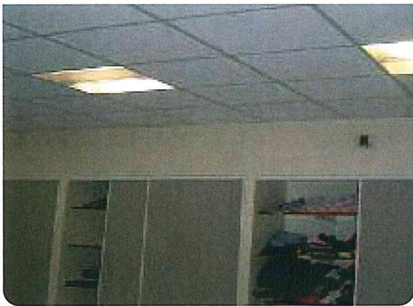
Photo 13 : Bouches d'extraction d'air dans un dortoir
