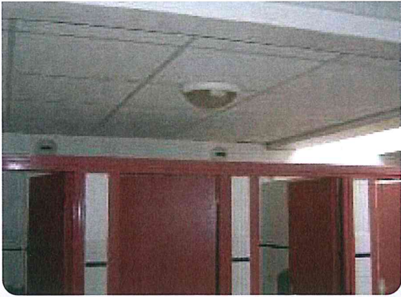
Photo 11 : Bouches d'extraction dans des sanitaires
