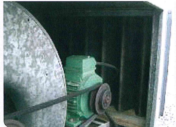
Photo 4 : Intérieur CTA avec filtre à air
