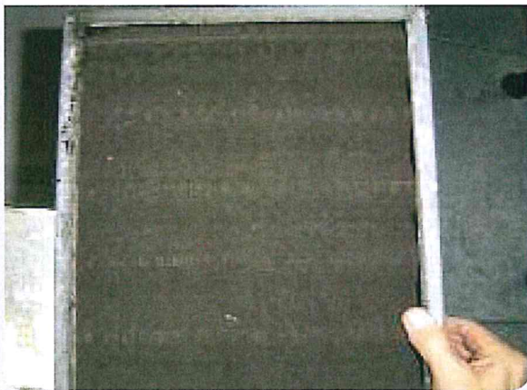
Photo 15 : Filtre de CTA très encrassé
