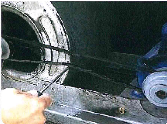
Photo 3 : Courroie ventilateur en mauvais état
