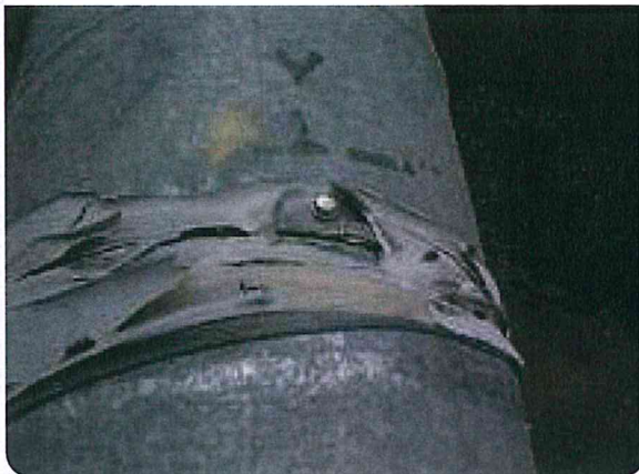
Photo 6 : Adhésifs détériorés sur conduits extérieurs
