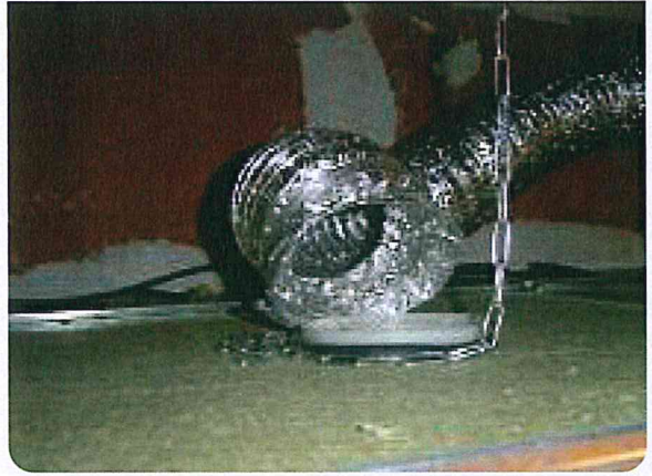
Photo 12 : Bouche déconnectée au-dessus du plafond
