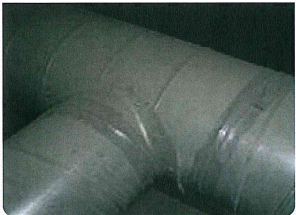
Photo 5 : Conduits étanches en combles
