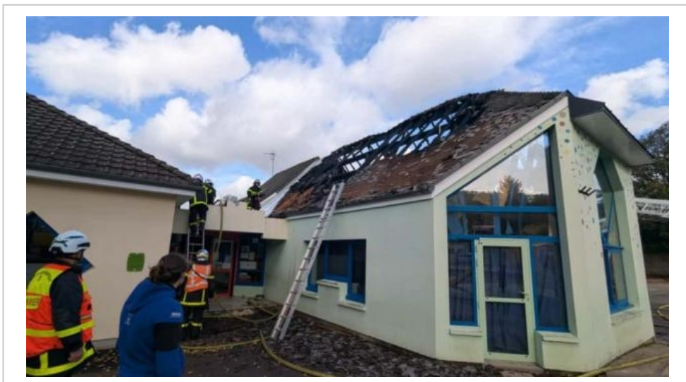
La toiture a été fortement endommagée. © Paris Normandie
