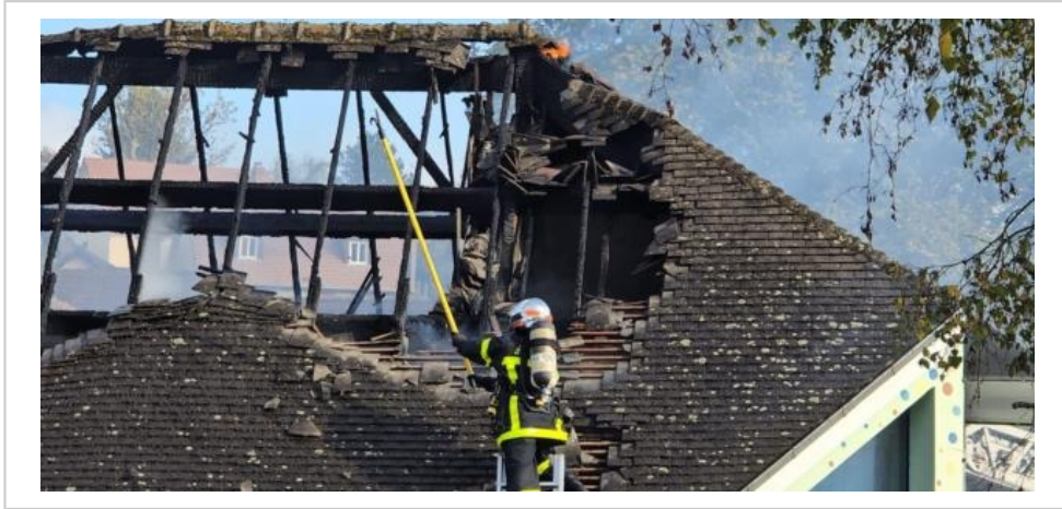
Un incendie a détruit la toiture de l'école de Saint-Aubin-Epinay, hier, en Seine-Maritime. © Droits réservés
