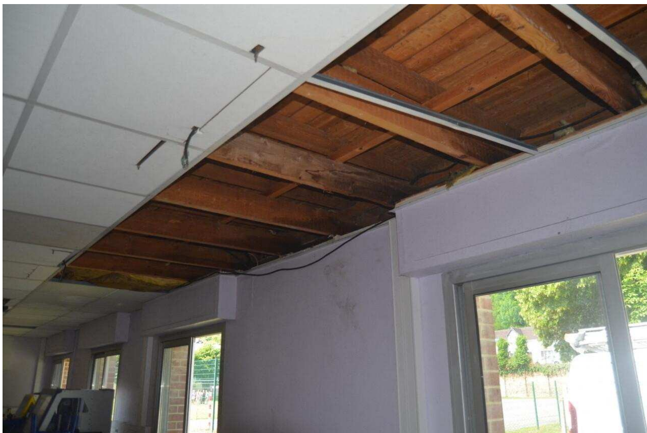
Plafonds effondrés au collège
