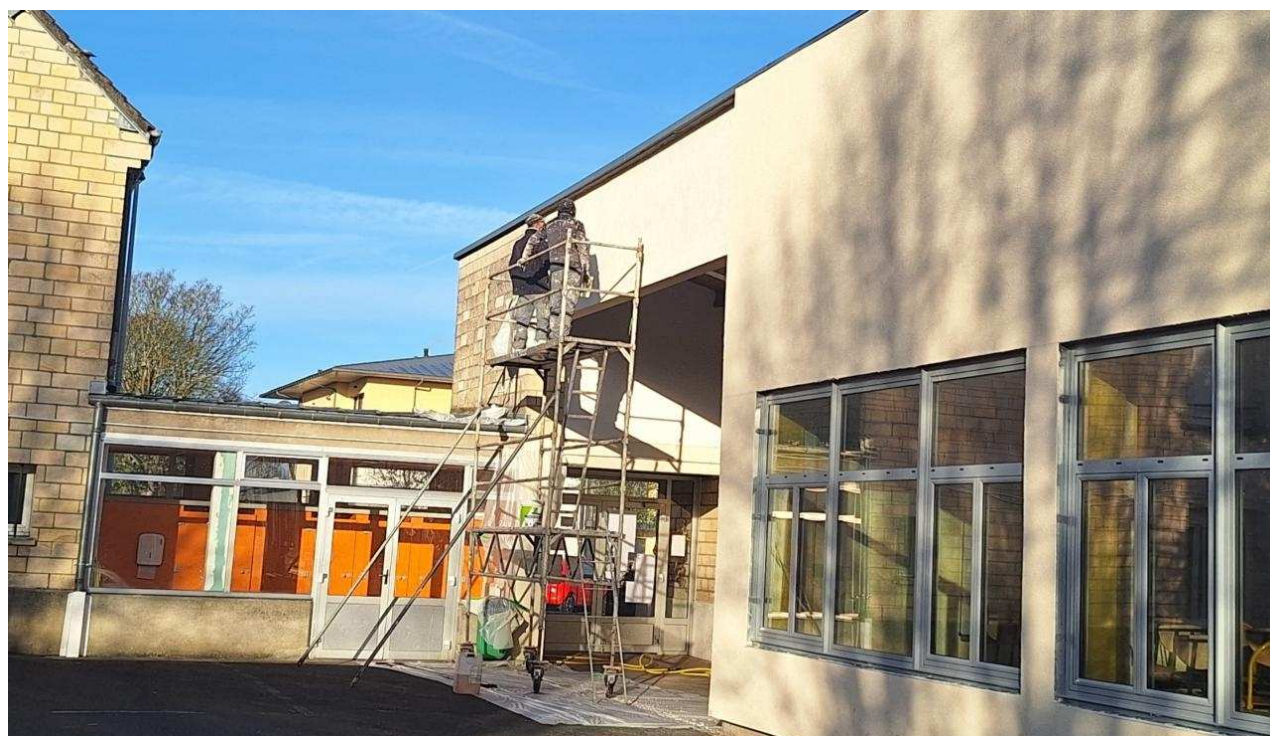
Le choix de l'isolation thermique extérieure donne l'occasion d'offrir une nouvelle jeunesse à la façade de l'école. Agnès Wack
