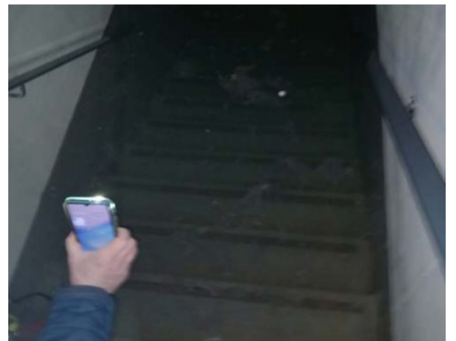
L'eau remontait jusque dans ces escaliers menant au sous-sol. Photo transmise par Florence Gautier
