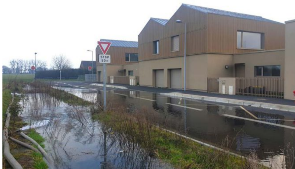
Le lundi 20 janvier 2025, les pompiers ont pompé 2 600 m 3 d'eau dans les sous-sols de la cantine du collège de Bourneville-Sainte-Croix (Eure). EG
