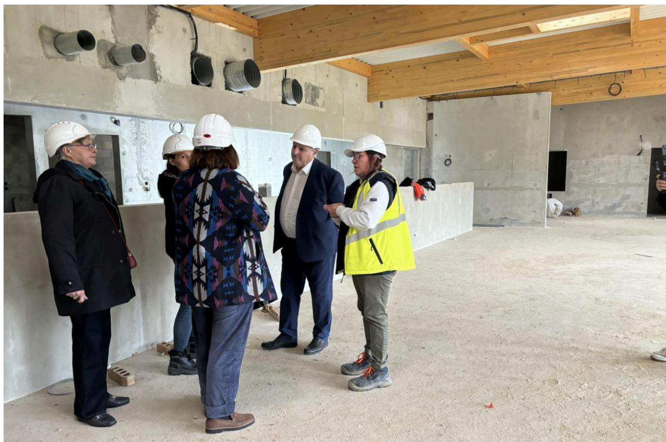
La visite du chantier s'est déroulée mardi 8 octobre avec les élus du territoire Marine SORIEUL
