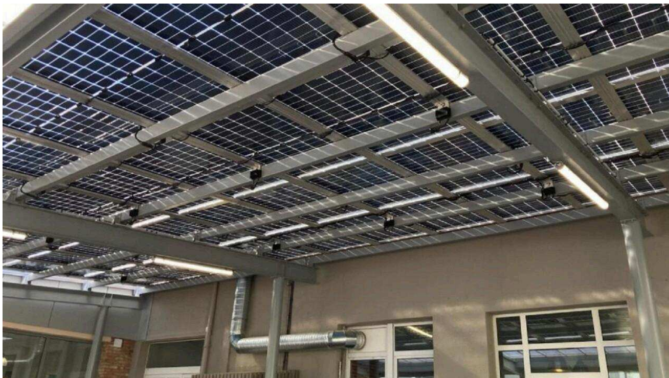
La centrale photovoltaïque de la cafétéria du lycée Saint-Thomas-d'Aquin à Flers (Orne).
