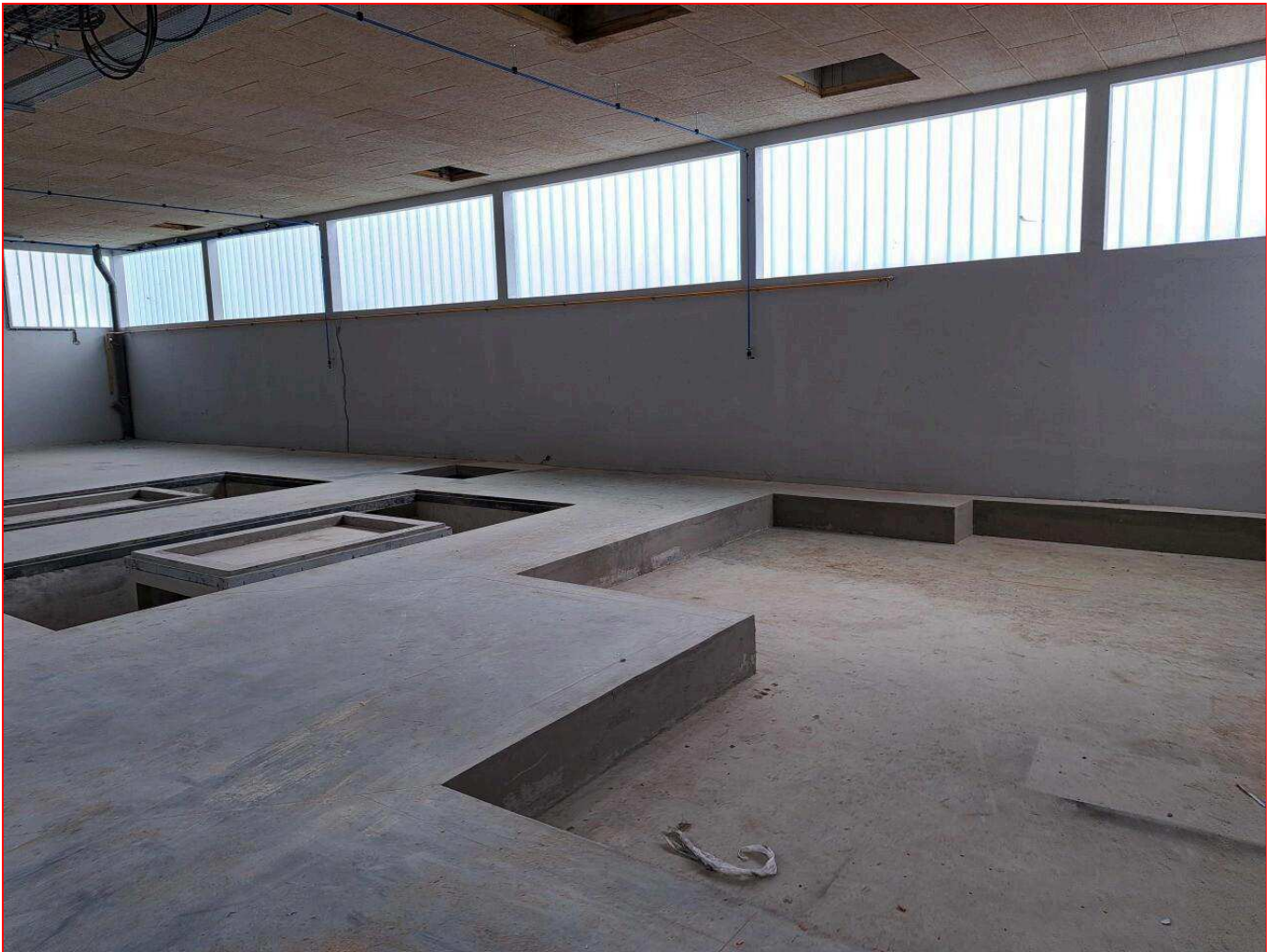
L'emplacement de la station de peinture ultramoderne dans l'atelier carrosserie.
