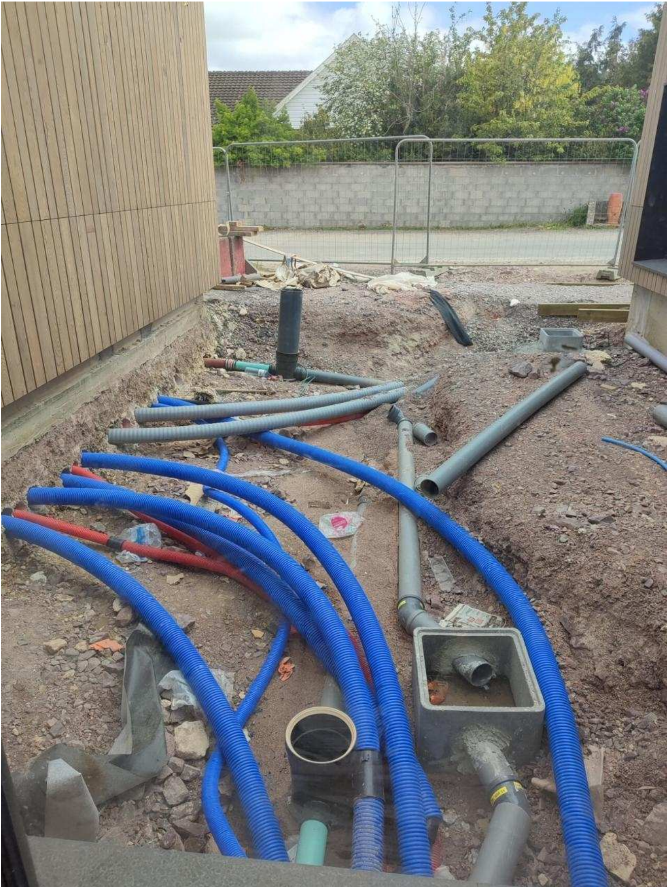
La géothermie est installée entre l'école et la cantine.
