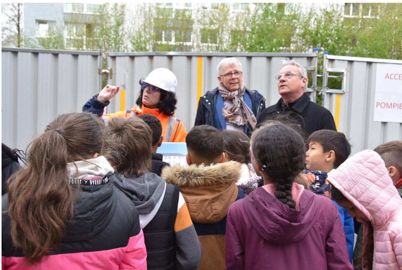
Delphine Sage, Gilles Lelong et Dominique Hébert visitent le chantier de l'école Noblet, à Cherbourg (Manche), avec les enfants de CE2/CM1.
