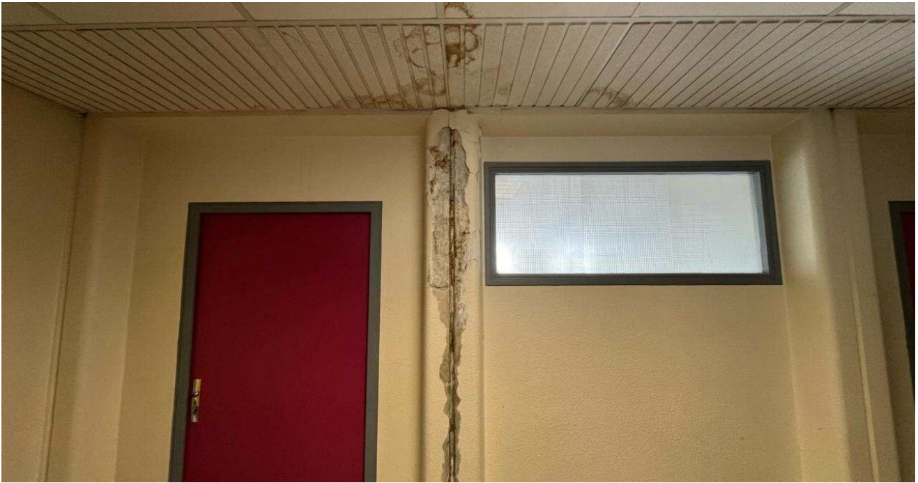
La peinture des murs s'écaille à de nombreux endroits au second étage du bâtiment. Ouest-France
