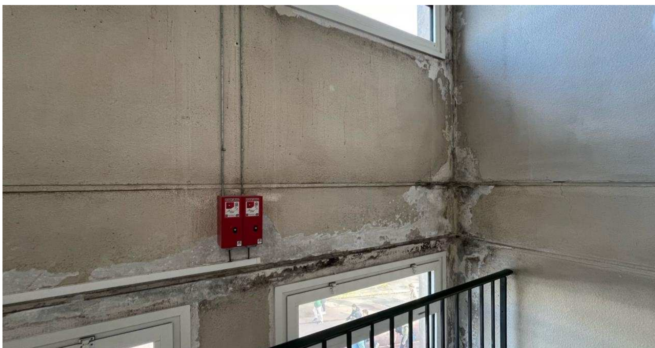
Dans la cage d'escalier du bâtiment, à cause d'infiltrations d'eau, des moisissures apparaissent. Ouest-France
