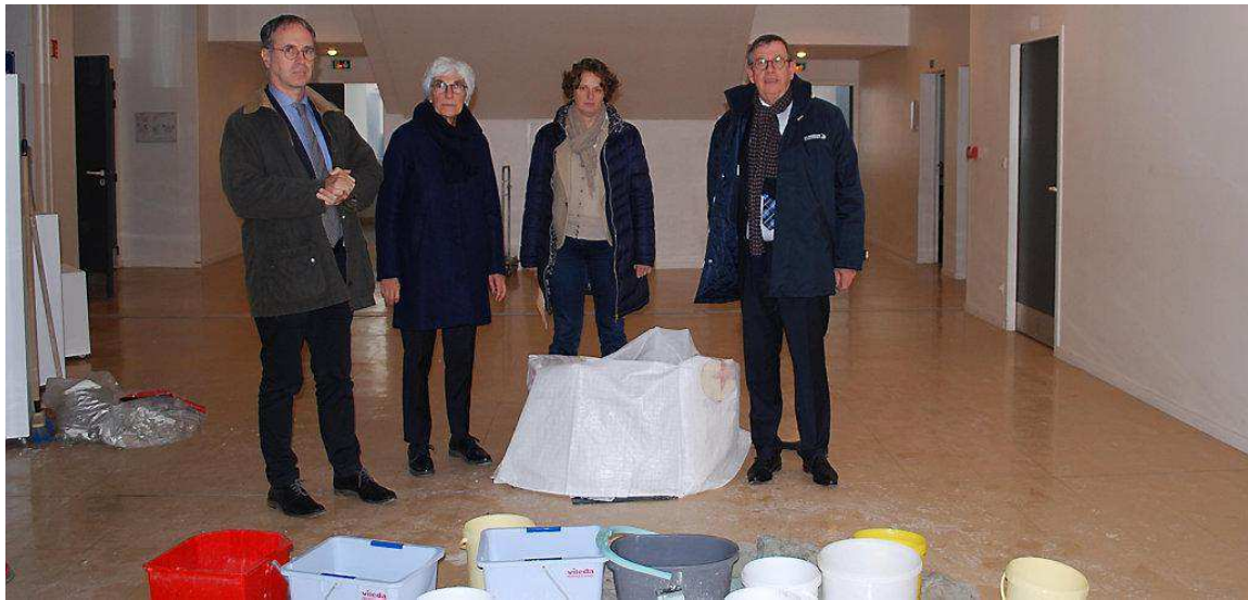
Elus et enseignants constatent les dégâts des eaux infiltrées à travers les plafonds depuis le 5e étage du collège coutançais.
