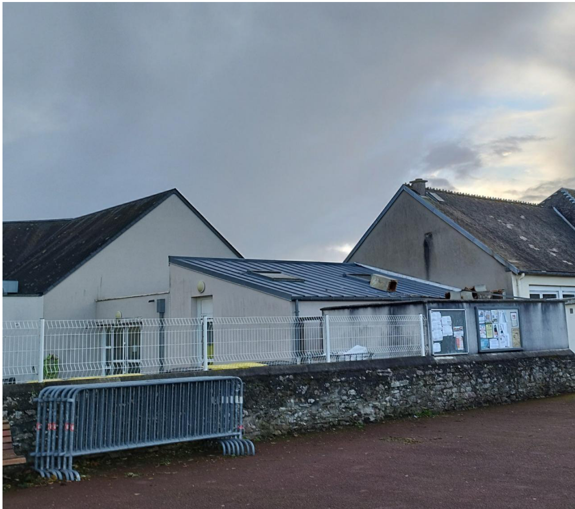
Au groupe scolaire Coccin'Elle, la cheminée de la chaufferie s'est envolée et s'est posée sur le toit des sanitaires de la garderie. Ouest-France
