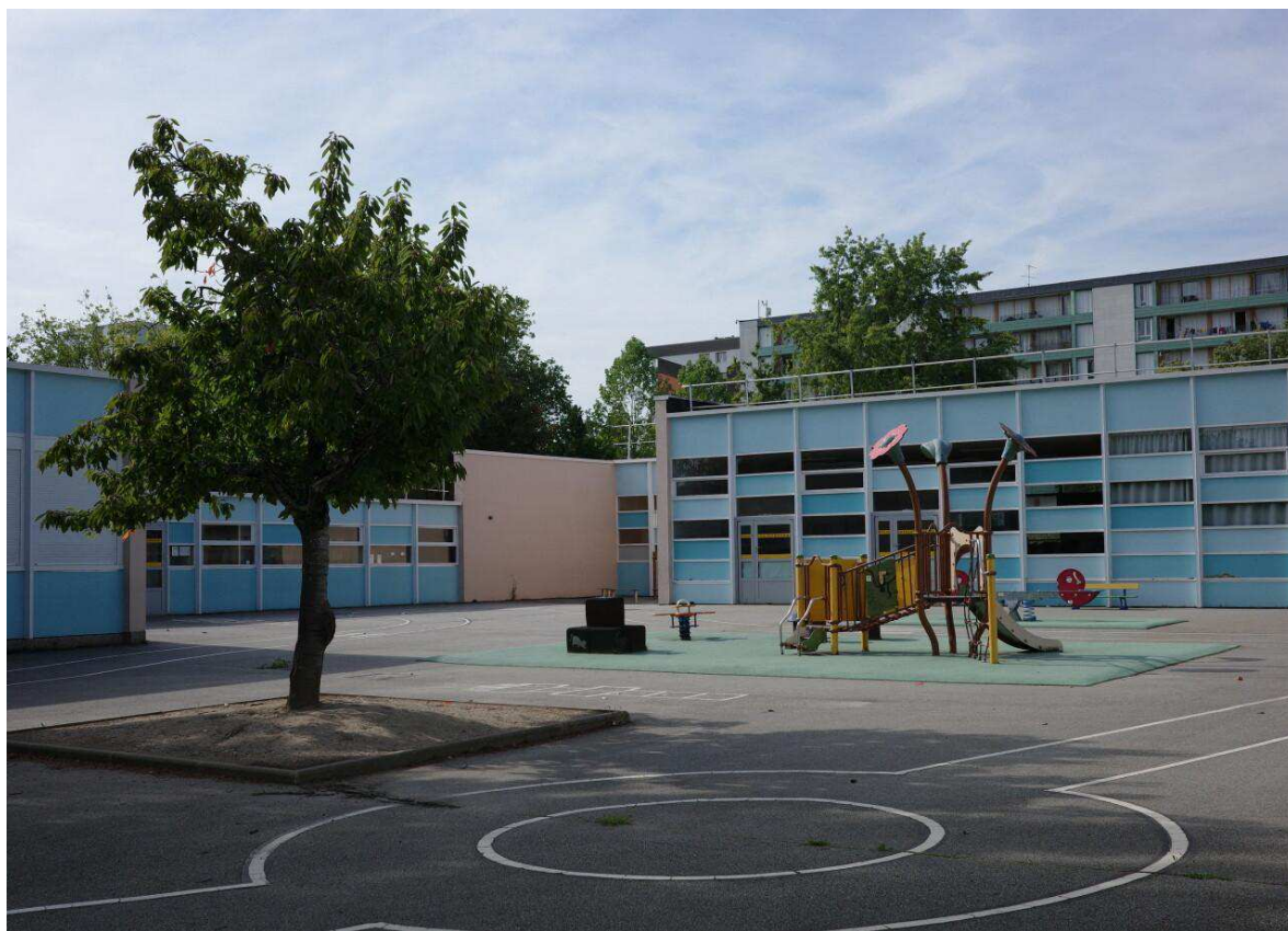
Des travaux de remise en état sont en cours dans l'école maternelle Jules-Michelet, à Évreux.
