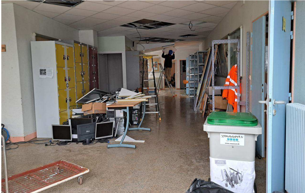
Les 2 500 m2 de l'établissement sont sous l'eau. ChG
