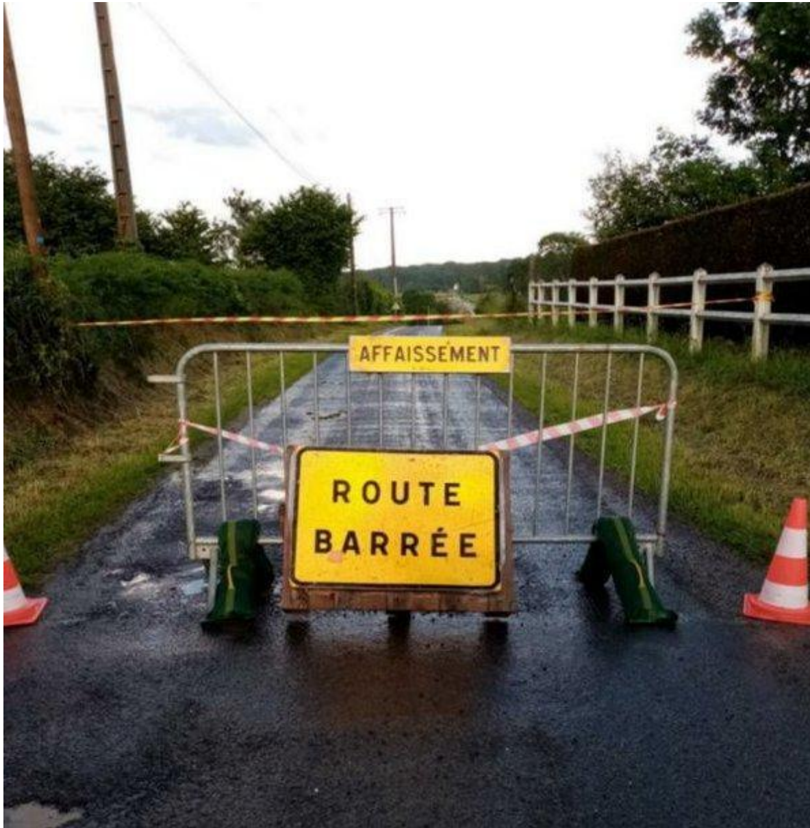
Une route s'est affaissée, d'autres ont été submergées lors des orages, ce week-end. wd D.R.
