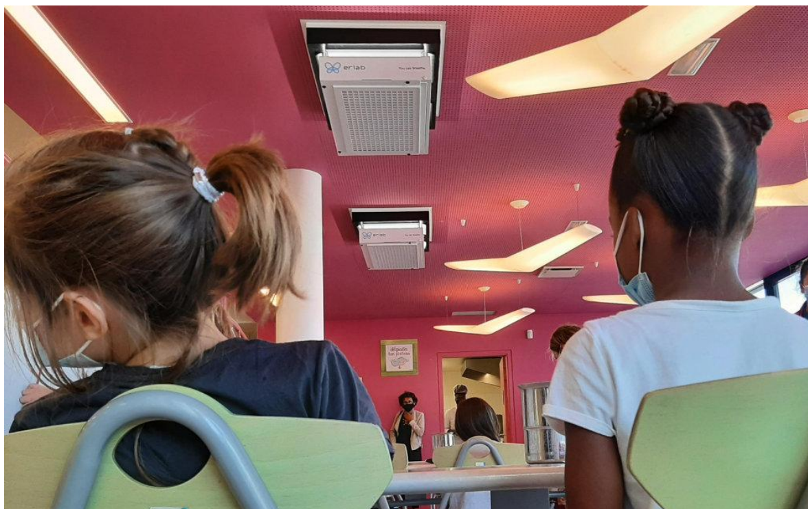
Les purificateurs d'air conçus par Erlab ont été installés entre les mois de juin et septembre au plafond de l'école Louise-Michel de Val-de-Reuil. ©La Dépêche de Louviers
