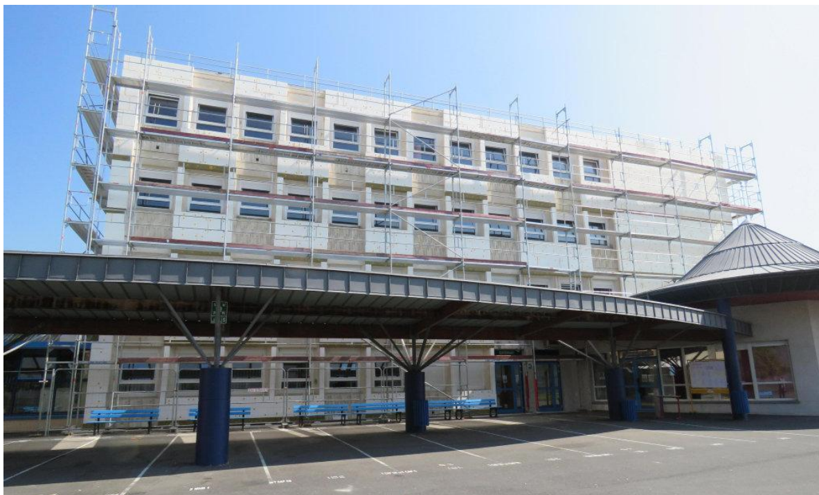
Parmi les travaux en cours, la rénovation des façades et l'isolation par l'extérieur des bâtiments.
