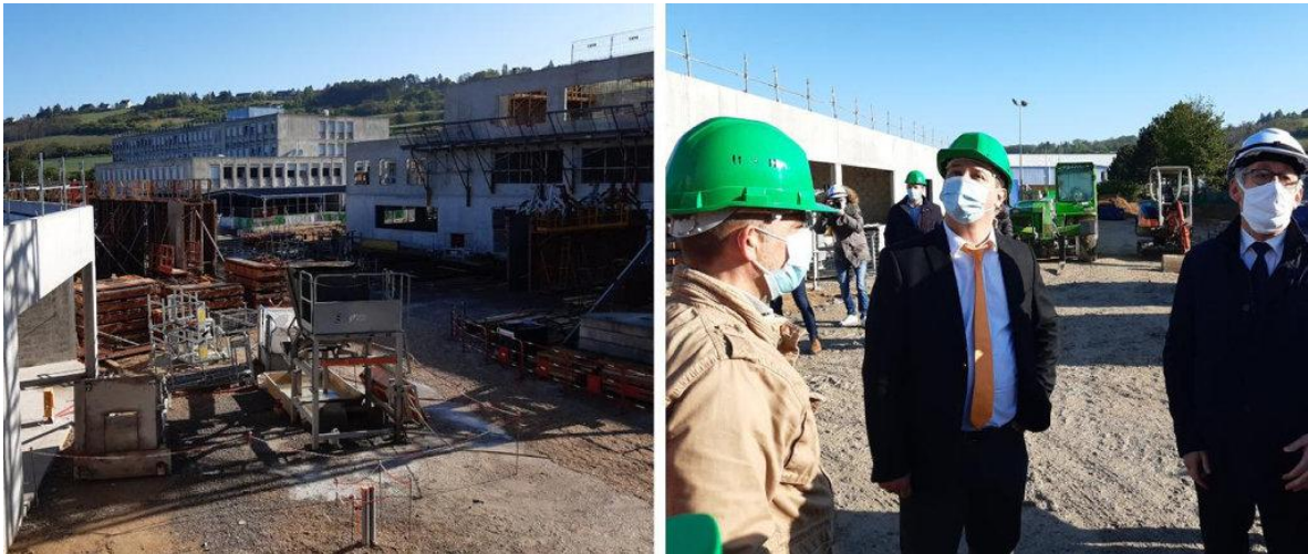
Le chantier du nouveau collège du Hamlet presque à mi chemin des travaux. (©La Dépêche de Louviers)
