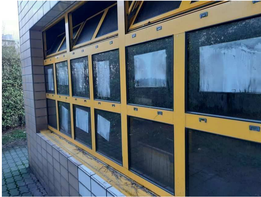
Les murs noircis du bâtiment ouest de l'école Lamartine, au Havre. (©PL/76actu)
