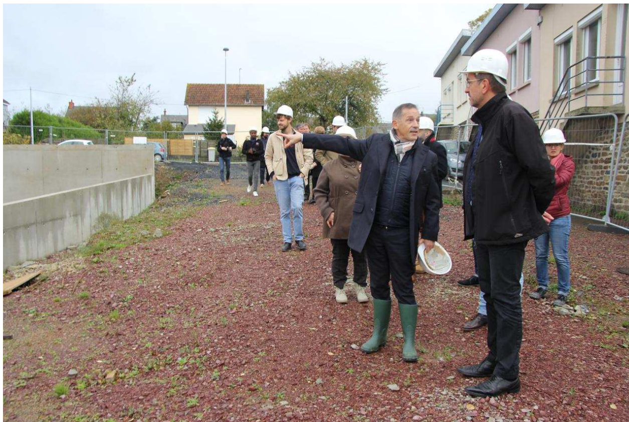
Une visite de chantier s'est déroulée mardi 5 novembre 2019 pour découvrir l'avancement des travaux de la future école Samuel-Beckett à Saint-Lô. - Crédit: Ouest-France
