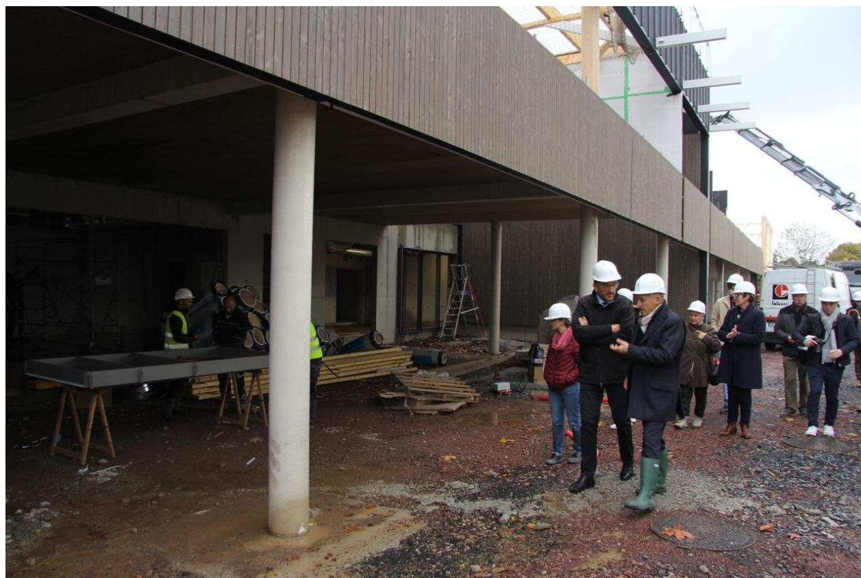
Une visite de chantier s'est déroulée mardi 5 novembre 2019 pour découvrir l'avancement des travaux de la future école Samuel-Beckett à Saint-Lô. - Crédit: Ouest-France
