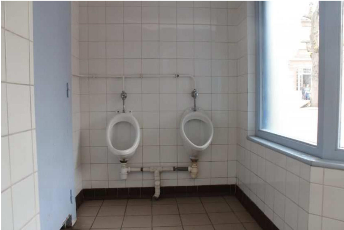
Les deux seuls urinoirs de l'école n'offrent aucun espace d'intimité pour les garçons. L'odeur est désagréable de façon permanente. (©DR)
